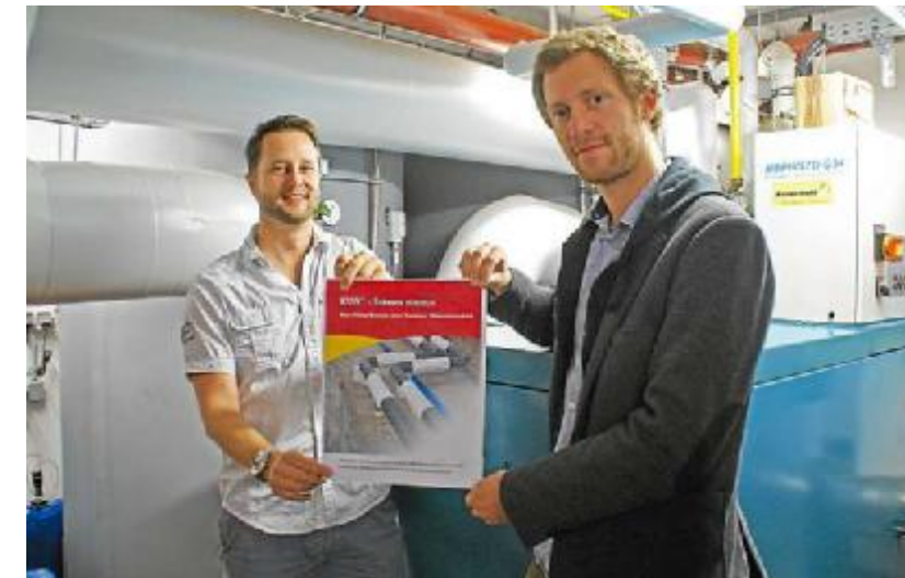
Die Klimaschutzmanager Marco Imberge (l.) und Julian Schütte vor einem Blockheizkraftwerk im Telgter Schulzentrum.
