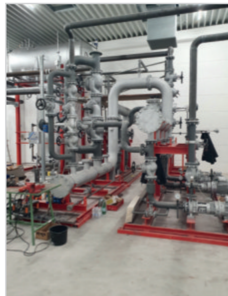
Blick auf die Fritteusen-Heizstation
